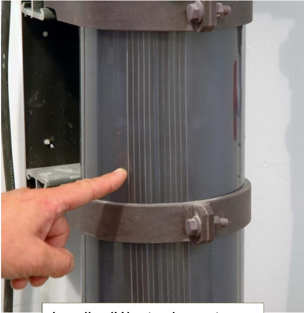
La pile d'électrodes est en excellent état et ne nécessite pas de nettoyage
